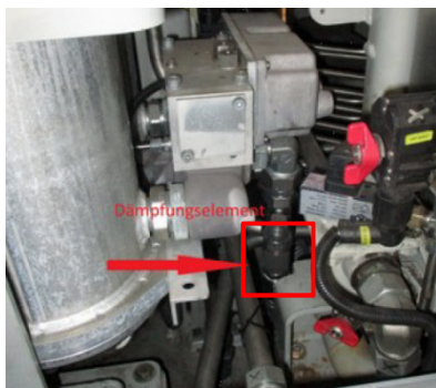
Abb.2 Einbauort PDV-DS in der Zuleitung zum Drucklufttrockner, Einbaulage vertikal
